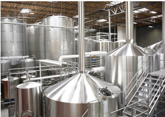
Fotografía 5. Sala de cocimiento de una cervecería.
